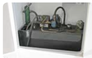
Система автоматической подкачки топлива
