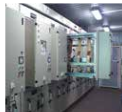
Вводно-распределительное устройство (ВРУ)
