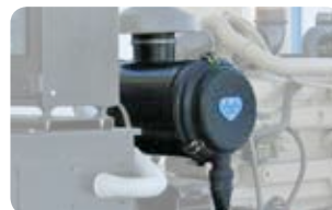
Слив конденсата из корпуса воздушного фильтра
